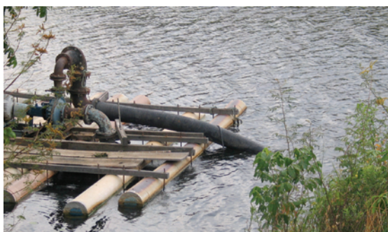
Figura 3 – Estrutura para captação a fio d'água em curso d'água superficial. Foto: Paulo Spolidorio / Banco de Imagens da ANA.
